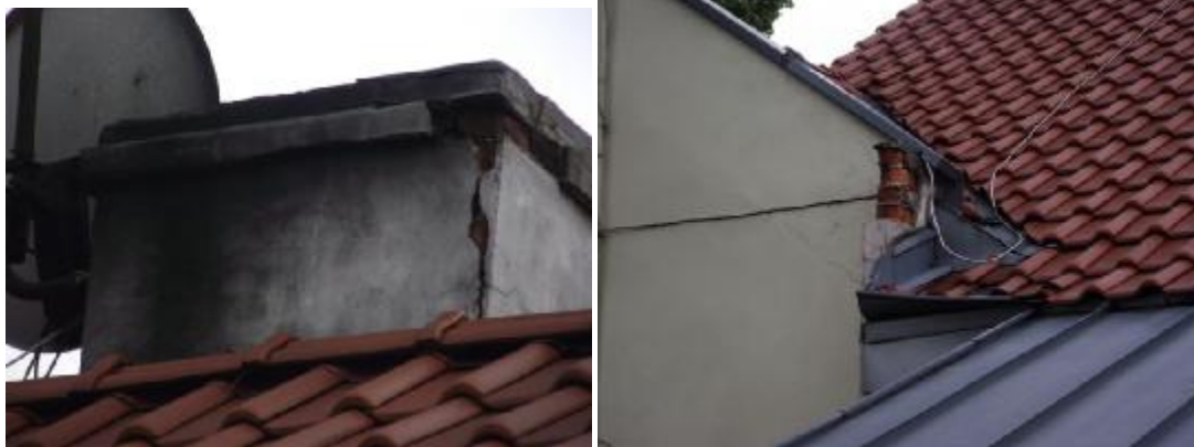
Fot.6. Fragmenty uszkodzeń komina i murków na dachu
