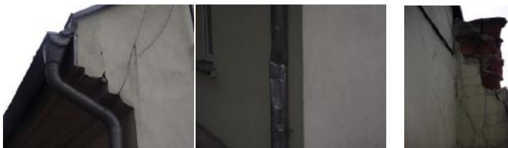
Fot.7. Uszkodzenia elewacji, orywnowania i innych przemurowań
