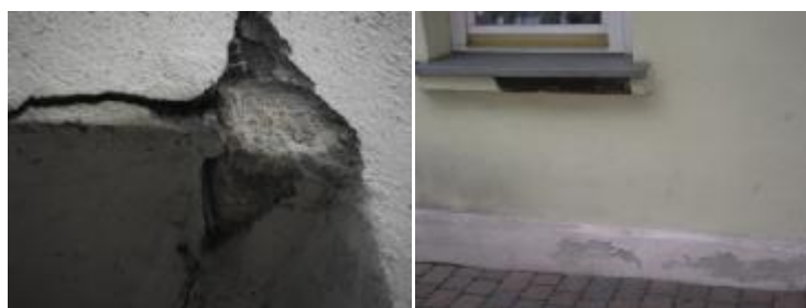
Fot.8. Uszkodzenia elewacji
