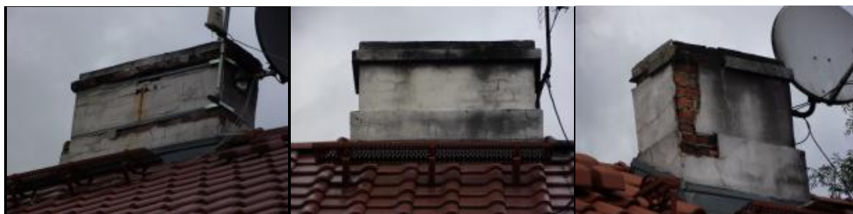
Fot.5. Wybrane uszkodzenia kominów
