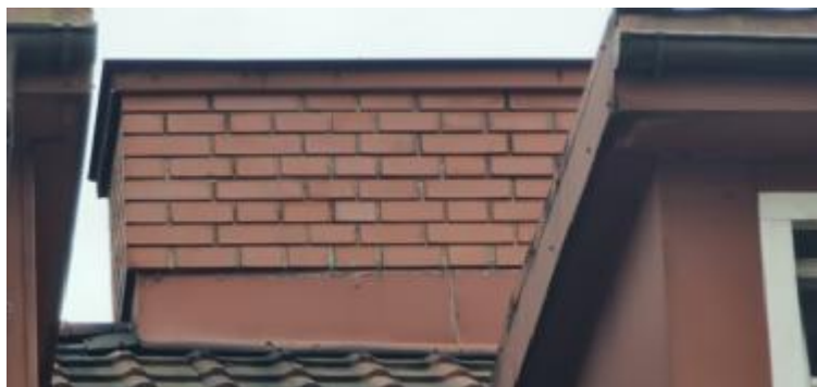
Fot.7. Komin z obróbkami blacharskimi
