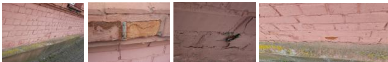
Fot.2. Fragmenty uszkodzeń elewacji frontowej
