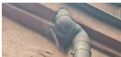
Fot.6. Uszkodzenia elewacji od strony podwórka
